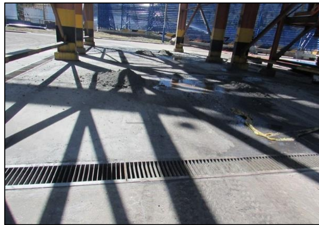
Fotografía 4. Rejillas de recolección de lixiviados de escorias
